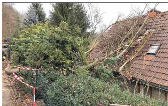
10.02.2020 – Sturmschaden in Halsbrücke
